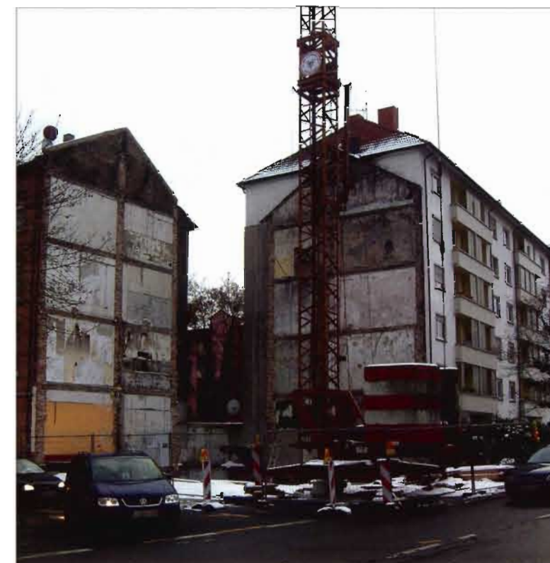
Abriss der Brandruine, Grube für den Neubau, Danziger Platz, Ludwigshafen/Rhein, 2009, Foto: Christoph Faulhaber
